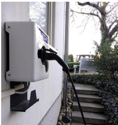
Wüstenrot testet die Ladesäulenverteilung auf dem Land. Foto: enisyst
