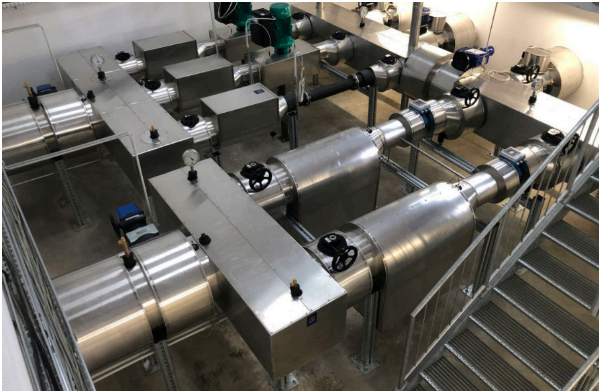
Foto: Anbindung in der Technikzentrale: Sie befindet sich etwa 800 m vom Bebauungsgebiet entfernt. Das gesamte Verteilnetz hat eine Länge von 13 km und fungiert als Wärmeübertrager. Quelle: Steinhäuser
