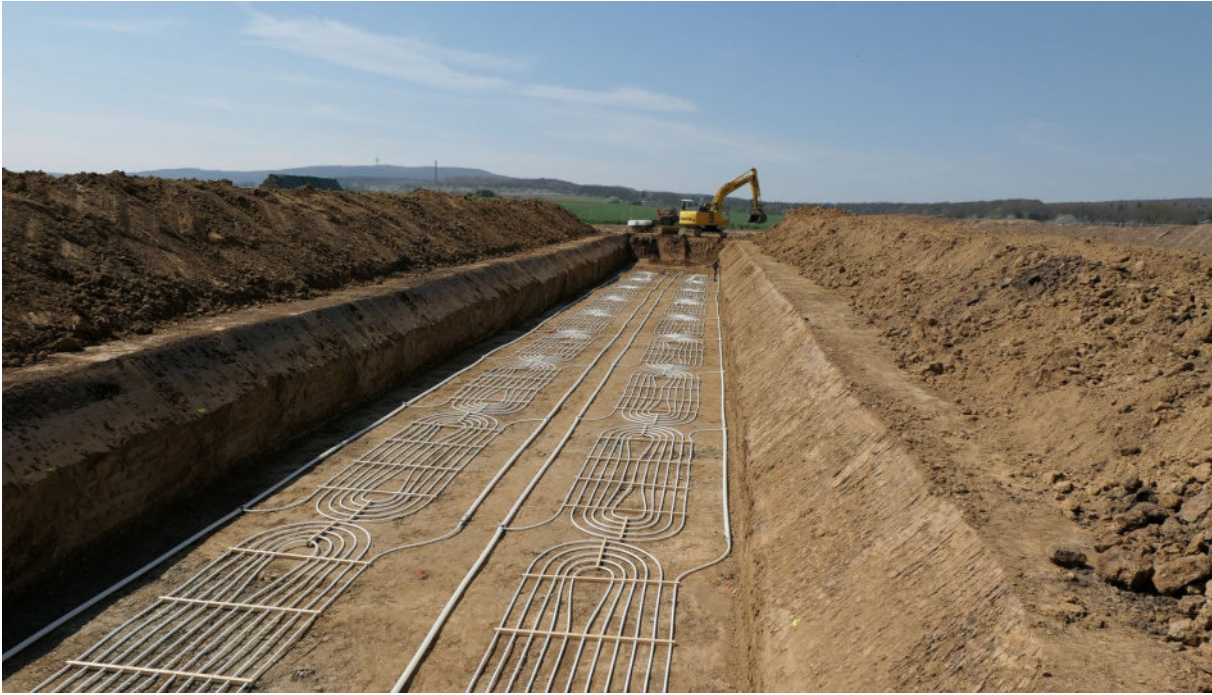
Foto: Verlegung der Rohre des „Boden-Klima-Tauschers“ in der unteren Ebene. Die zweite Lage wird 1,5 m darüber verzogen. Quelle: Steinhäuser
