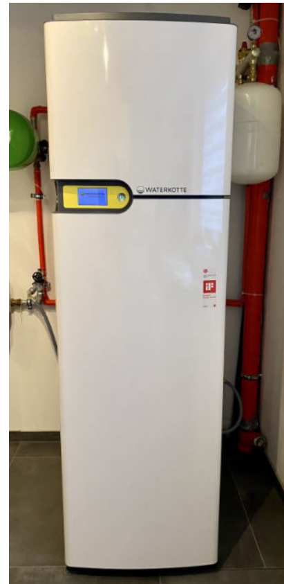
Foto: Etwa 180 solcher Wärmepumpen werden die rund 400 Wohneinheiten beheizen. Quelle: Waterkotte
